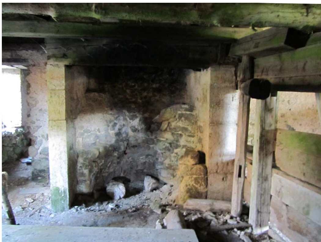
Et coup de grâce à notre sensibilité, l'effondrement lent mais imparable des parties en dur.
