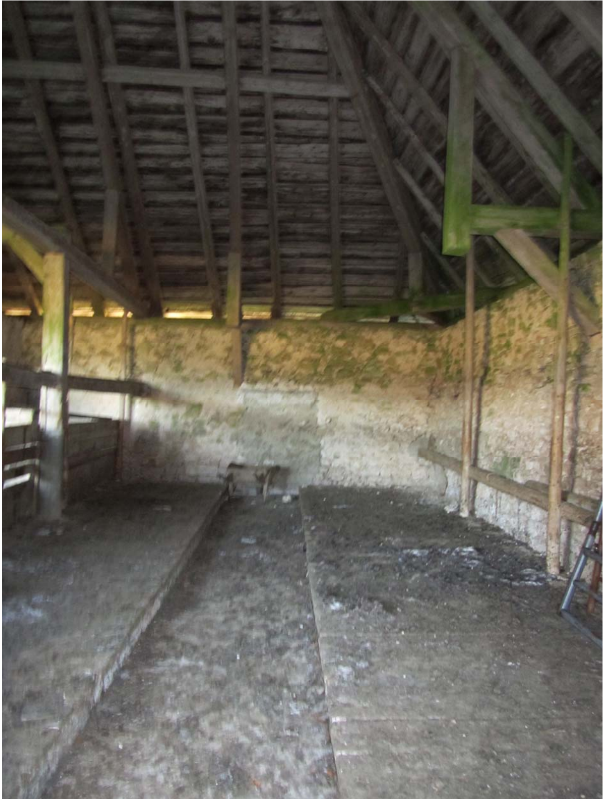
Des écuries abandonnées qui n'accueillent plus que les débris du mur résultant de sa lente désagrégation.
